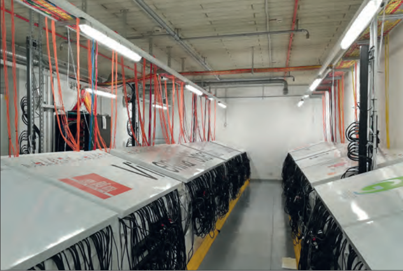
Außenansicht: ein Teil des Clusters VSC-3 (© VSC / Josef Beiglböck)
