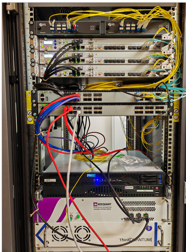
Abb. 1: Ein Netzwerkknoten mit QKD-Geräten, KMS und Netzwerkverschlüsseler (von unten nach oben | Foto: AIT)
