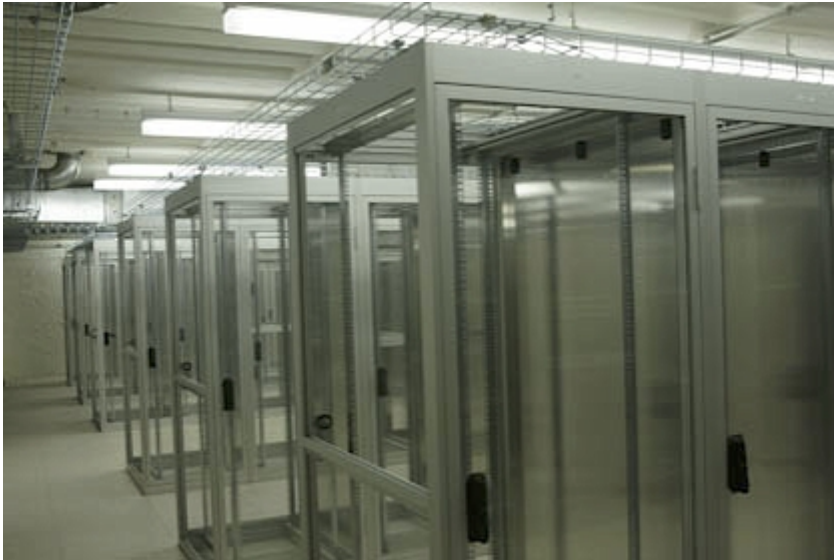
Schränke im neuen Carrier-Bereich des VIX1
